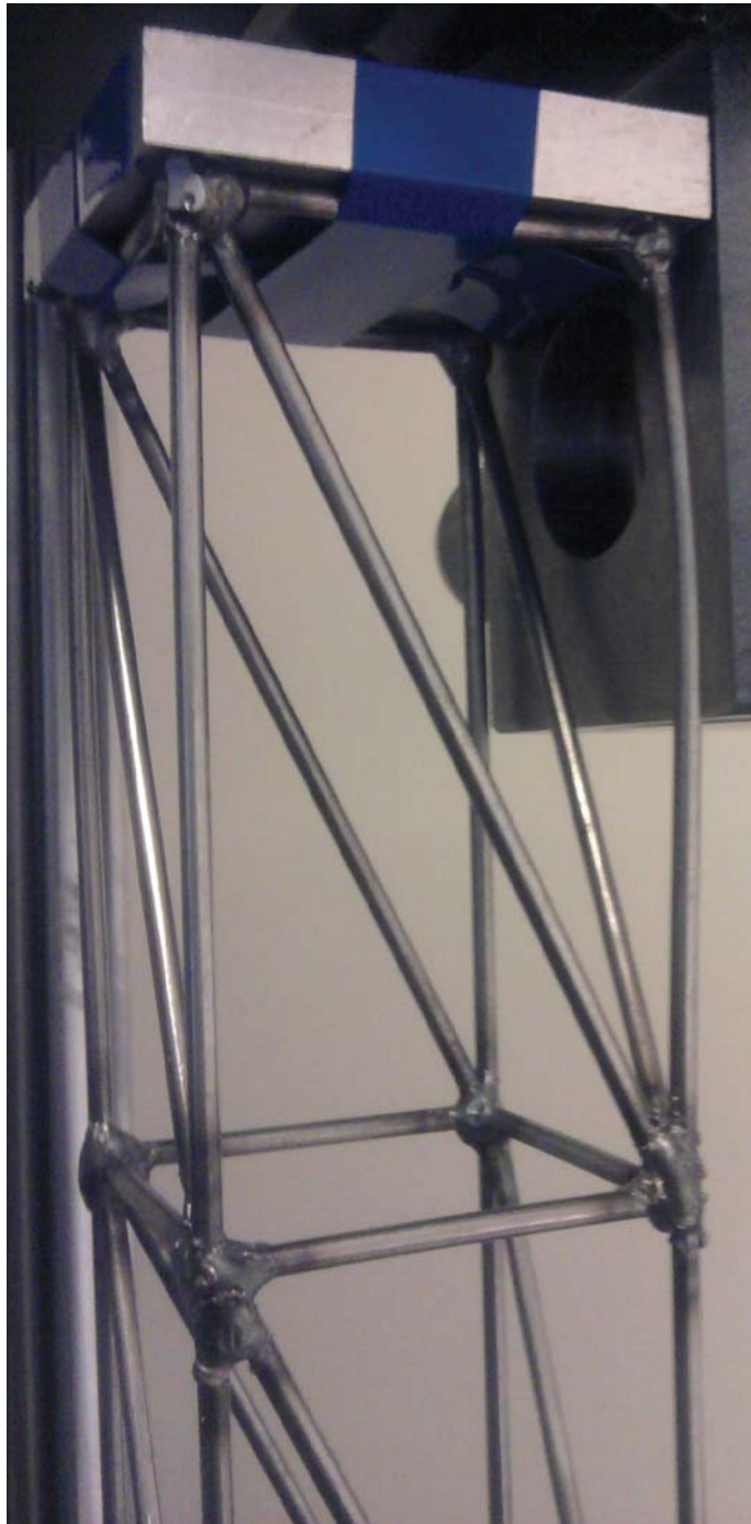
Fot. 2 .Wyboczenie lokalne masztu z przykładu 1
