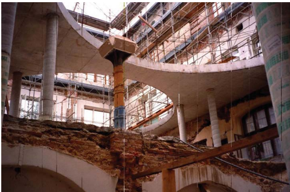
Rys. 14. Usztywnienie ścian fasadowych podłużnicami i żelbetowym stropem – widok z poziomu piwnicy (fot. autor)
